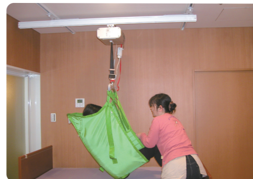
●天井走行リフト：車いす ⇄ ベッド ⇄ シャワーキャリー
